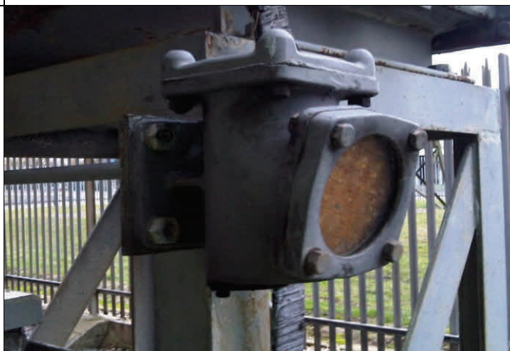
Ancien assécheur difficile à recharger.
